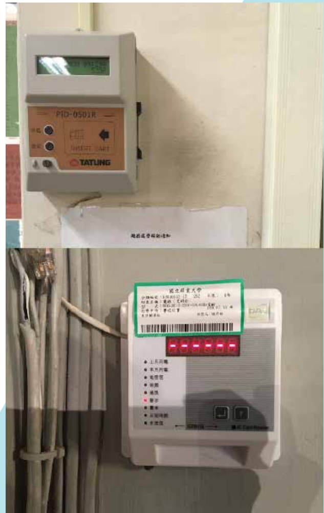
各校區分離式冷氣管理系統
